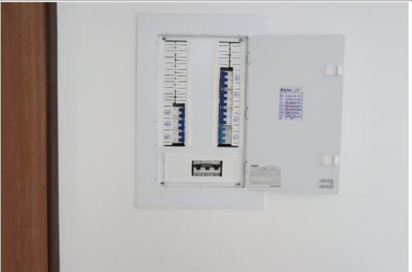
quadro de distribuicao de energia e disjuntores
