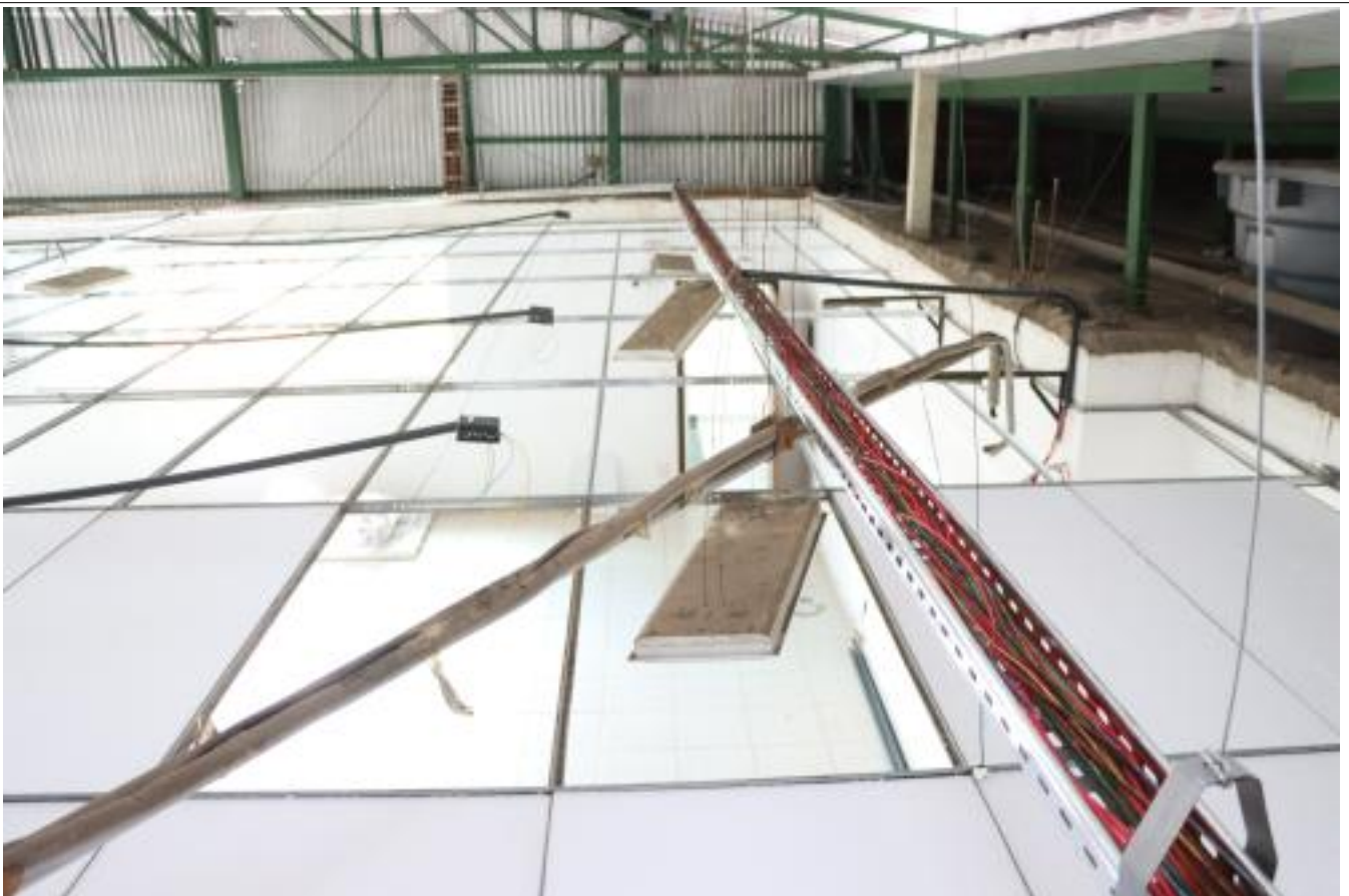
eletrocalhas e cabos
